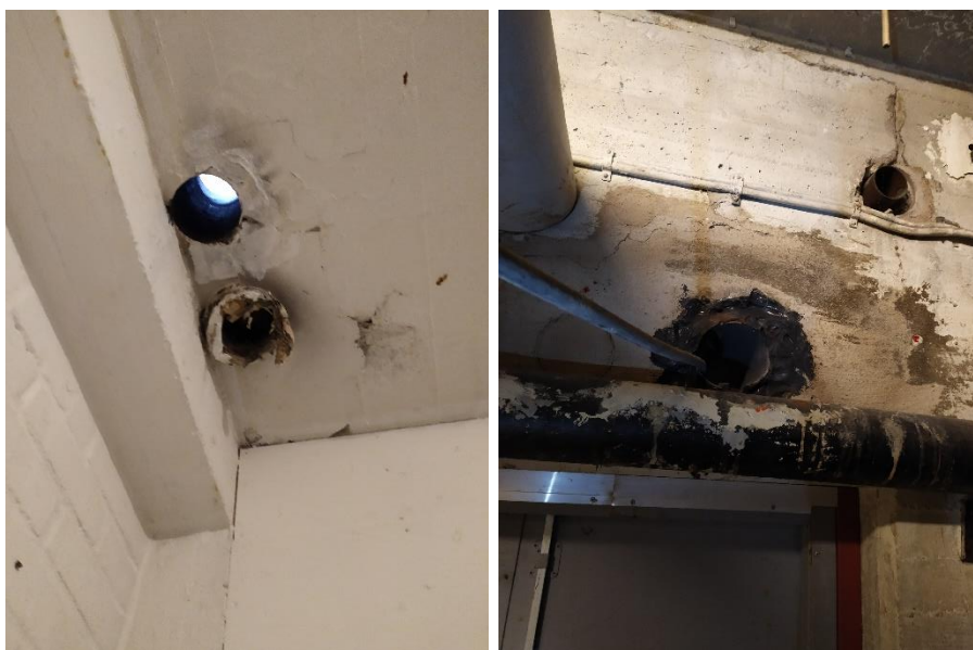
Figur 11: Exempel på kabelgenomföringar i tak och vägg. Bildkälla: AFRY 2020-06-25.
