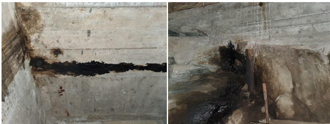
Figur 23: Oljeförorening i tak t.v. Misstänkt oljeläckage genom vägg t.h. Bildkälla: AFRY 2021-04-21.
