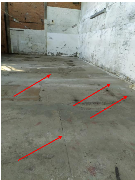
Figur 3: Fogar i golv i rum 101 på markplanet. Bildkälla: AFRY 2020-06-25.
