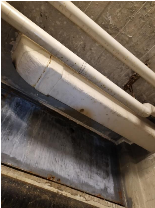
Figur 5: Ventilationskanal i innertaknivå i rum 02 på källarplanet. Bildkälla: AFRY 2020-06-25.
