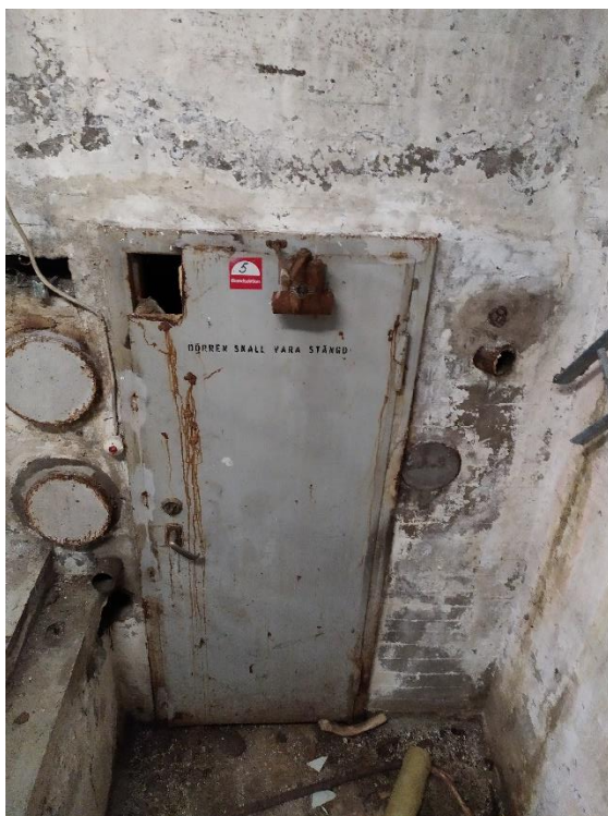
Figur 14: Äldre dörrstängare på branddörr i rum 05 på källarplanet. Bildkälla: AFRY 2020-06-25.
