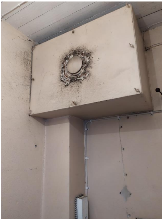
Figur 6: Ventilation i rum 105 på markplanet. Bildkälla: AFRY 2020-06-25.
