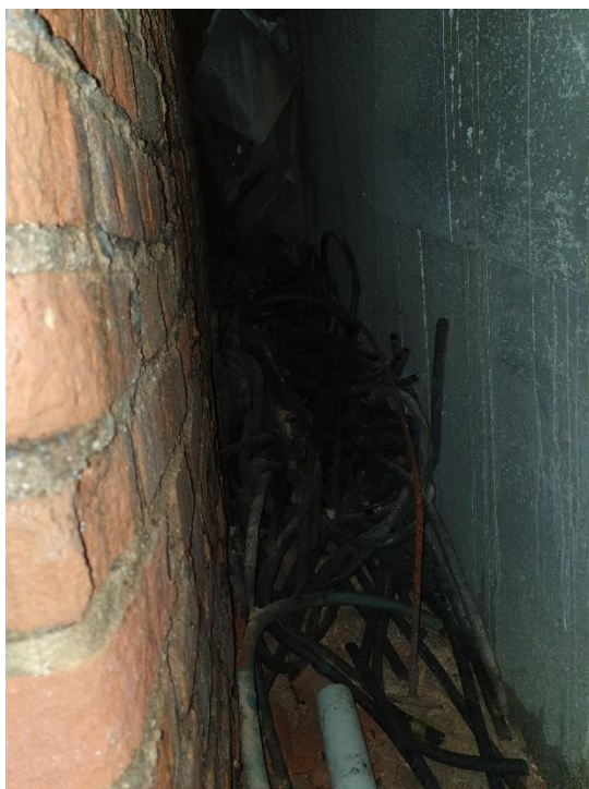
Figur 22: Kvarlämnade kabelhöljen i röckanal. Bildkälla: AFRY 2021-04-21.
