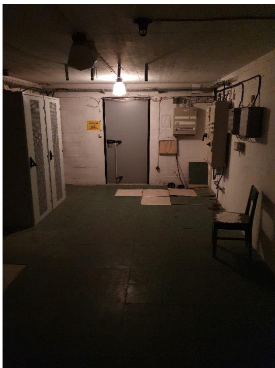
Figur 12: Ställverksplattor i rum 06. Bildkälla: AFRY 2021-04-21.
