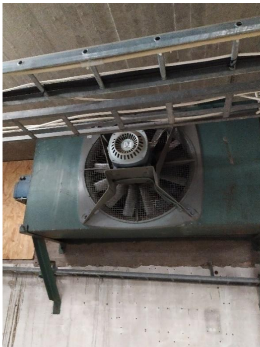
Figur 10: Ventilationsanläggning i rum 05 på källarplanet. Bildkälla: AFRY 2020-06-25.
